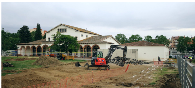
Imatge dels primers passos de les obres d'ampliació de l'edifici Mancomunitat 2 (M2).
